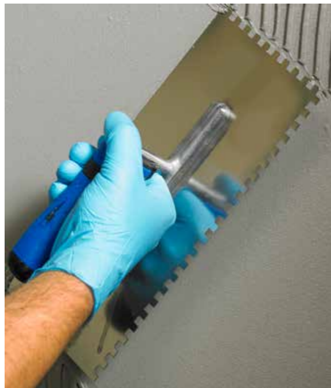
1. Nach dem Aushärten der ersten Schicht wird die zweite Schicht wahlweise mit einem Spachtel aufgetragen.
