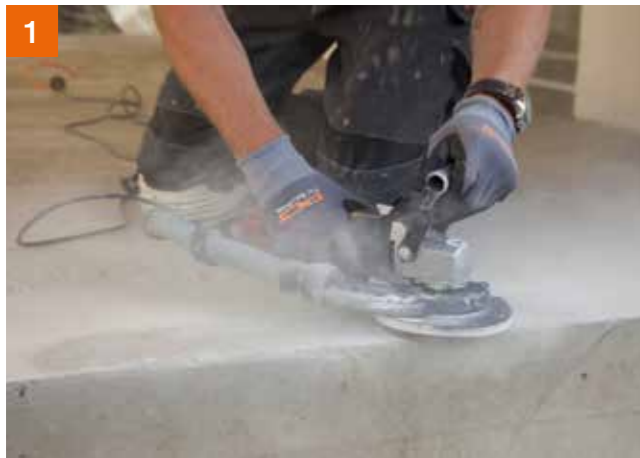
1 Grate und scharfe Kanten sind mit geeigneten Mitteln zu entfernen.
